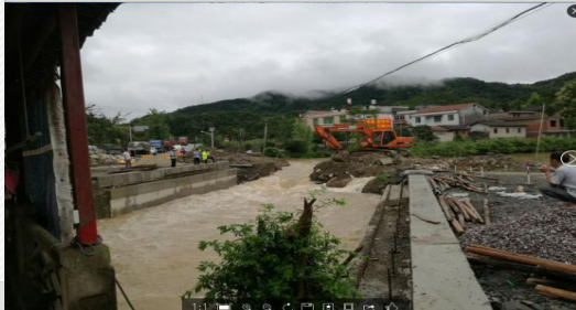
施工便道被冲毁
